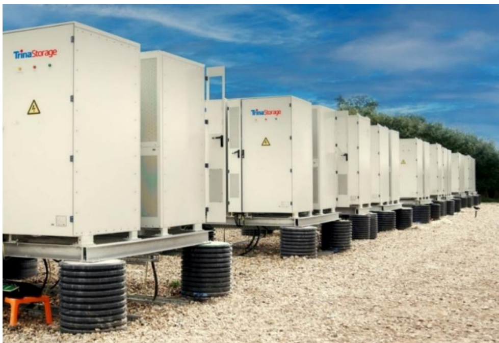
4.4.1. attēls. BESS konteineri tuvplānā (ilustratīvs attēls, autors: Kristīne Eglīte)
